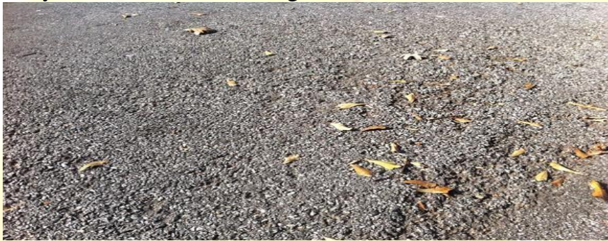
Fig. Raveling (very porous asphalt)
