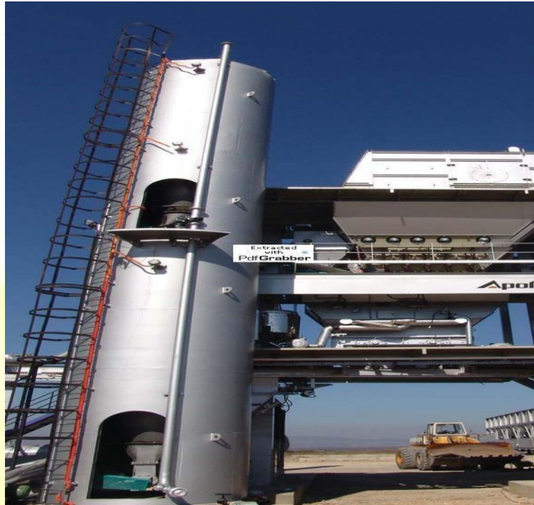
Fig. Mineral filler unit
