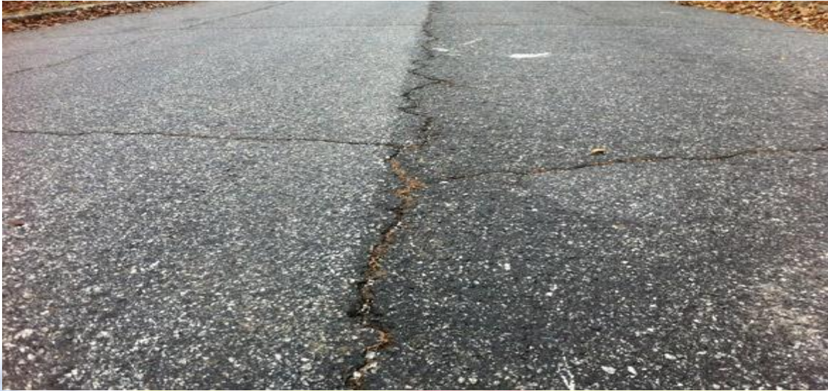
Longitudinal (Linear) Cracking
