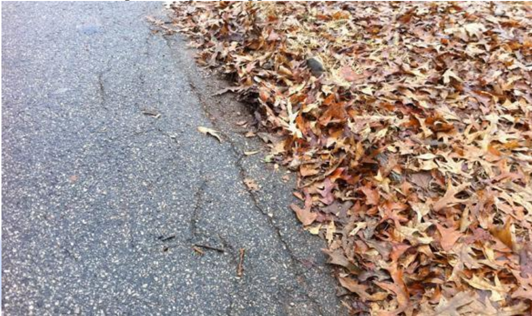
Fig. Edge Cracks
